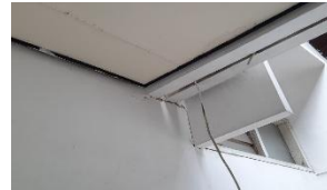
Retak disekitas jendela
