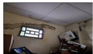
Jamur pada dinding
