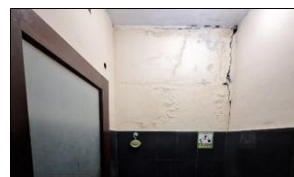
Retak dan Jamur pada dinding
