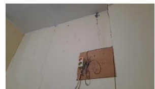
Retak pada dinding
