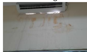
Retak pada dinding
